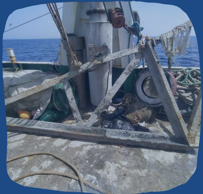
Μεταλλική βάση ηλεκτροδότησης
